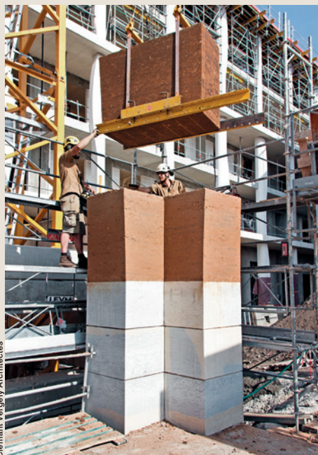
Am Fuß der bis zu 4 t schweren Blöcke stampfte Lehmbaumeister Nicolas Meunier Gewindestangen ein. So konnten sie mit einem mobilen Kran millimetergenau gesetzt werden.
